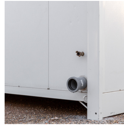
Connexion aux réseaux
